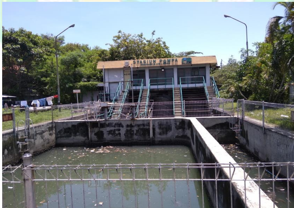
Gambar 18. Stasiun Pompa Air untuk mengatur pembuangan limbah air (Dokumentasi Penulis, Cirebon 5 Maret 2019)
